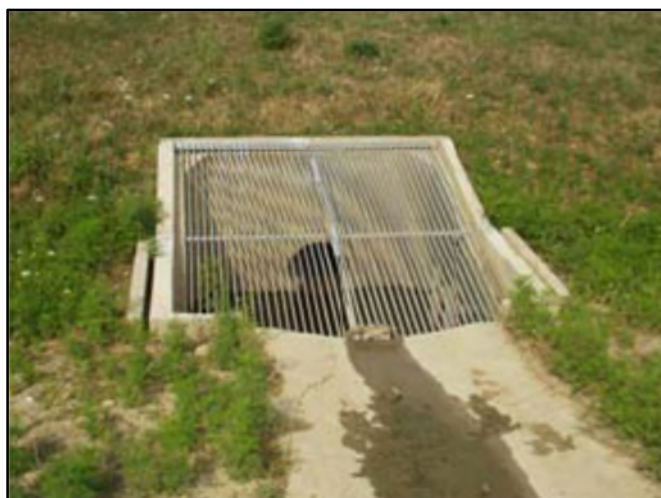
Figure 19 : Grille de protection sur ouvrage de sortie
